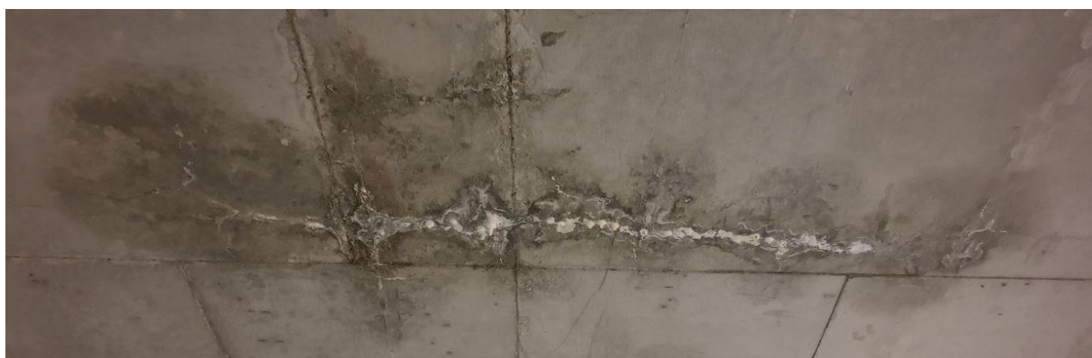
Obr. č. 4 – Tj. až bude stropní konstrukce masivně pokryta takovými trhlinami bude nutné uvažovat o celkové rekonstrukci
