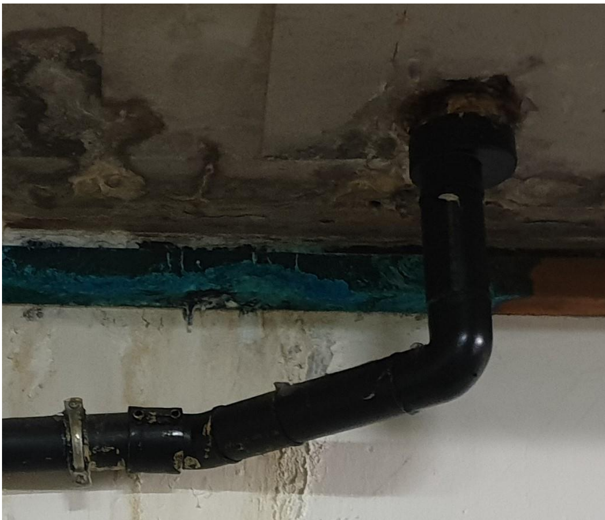
Obr. č. 8 – Výřez z Obr. č. 3, kde je patrná koroze měděného žlábků
