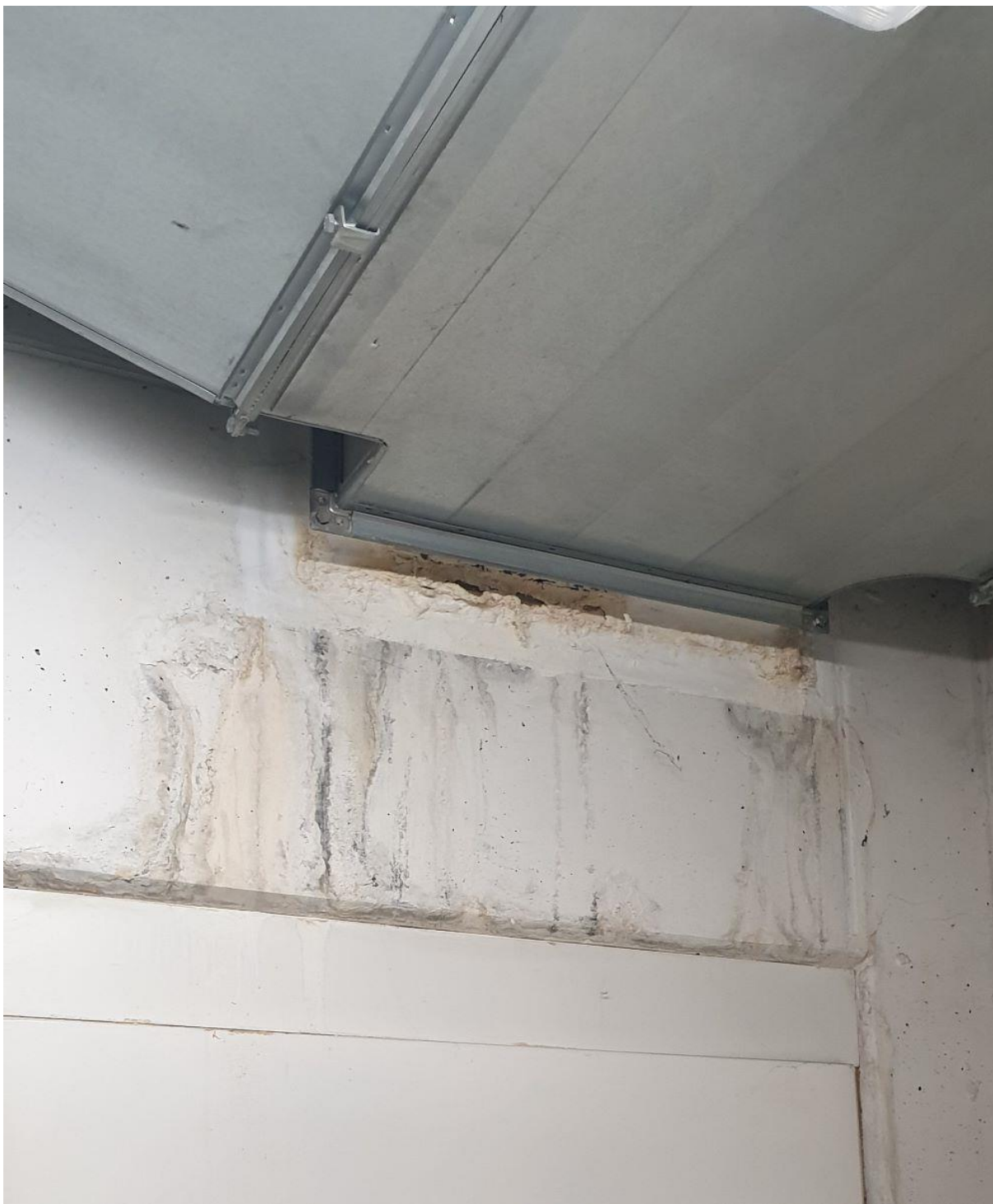
Obr. č. 5 – Příklad zatékání kolem vzduchotechniky
