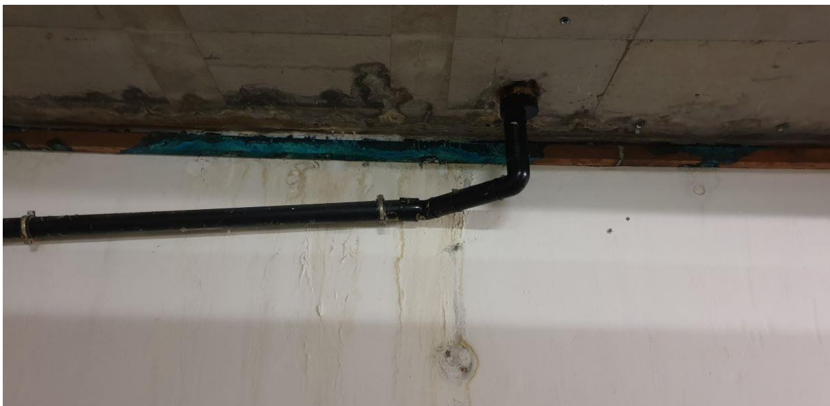
Obr. č. 6 – Zatékání svedené do svodného žlábků, resp. převrtaná vpust
